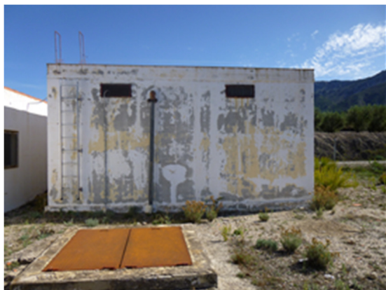
Arqueta del brocal del pozo Cremaes y depósito Cremaes
